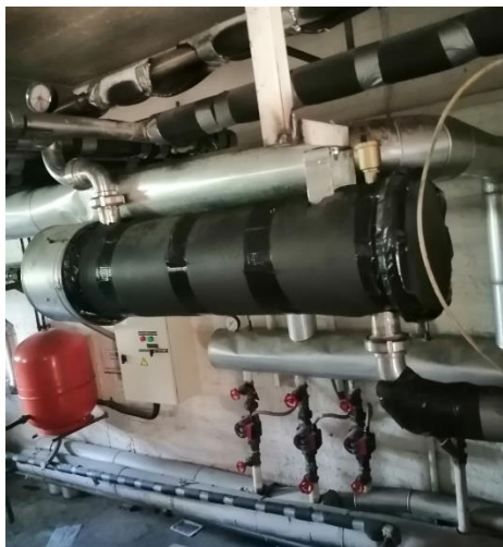
Слика 4.30 Електрични грејачи за одржавање температуре у ванрадном времену
